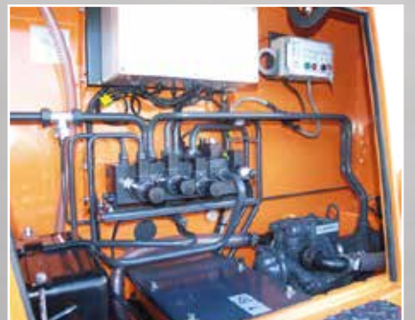
Zugänglicher Aggregaterraum für alle Steuerungselemente geschützt und gut zugänglich.
